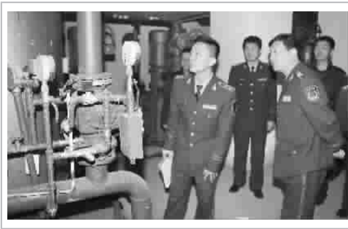
2月27日至28日,由公安部消防局组织的社会消防工作检查组在市委常委、政法委书记、公安局长廖克洪等领导的陪同下,检查指导我市构筑社会消防安全“防火墙”工程建设情况。检查组随机抽取了市京华园、燕良大酒店、市实验小学、人商超市等单位进行检查,对我市构筑社会消防安全“防火墙”工程建设给予充分肯定,并提出了一些整改意见。图为检查组在市金灿灿娱乐城检查消防设施。 记者刘旻 通讯员刘惊涛 摄
