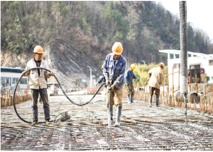
日前,工人正在竹山县城关镇窑沟村新建的桥梁上浇筑混凝土,该桥梁是通往窑沟村安置点的控制性工程。为打赢脱贫攻坚战,在农村公路建设方面,竹山县交通运输局近两年来总投资5.17亿元,规划建设农村公路516公里,改造危桥33座,建成“四好农村路”示范路1200公里。
