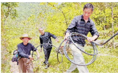
郧西县店子镇建设农村饮水工程水管。特约记者杨洪霞 摄
