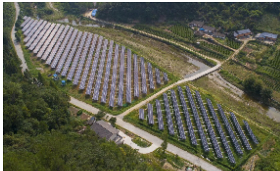
茅塔乡大坪村光伏电站
