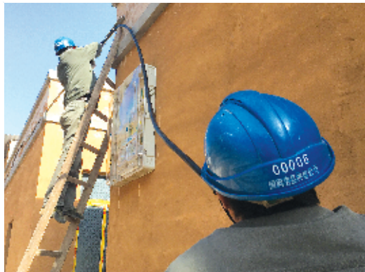
易迁小区电力设施配套
