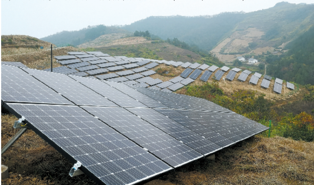
县河镇光伏发电基地
