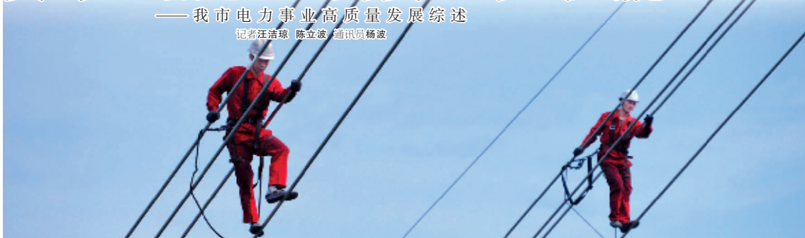
电力员工云端巡检500千伏十陵线(资料图片)
