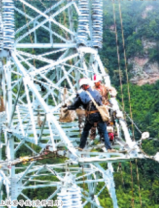
电力员工在220千伏十陵变电站内对号核送上架导线(资料图片)
