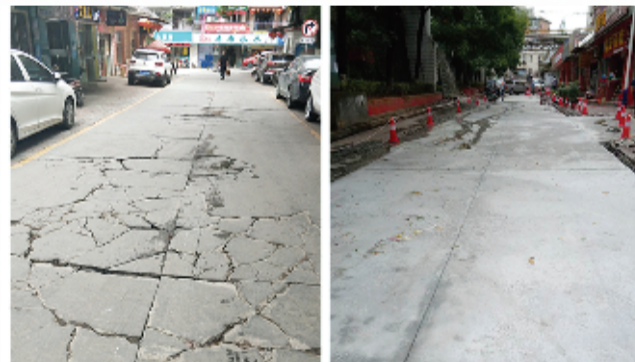
祥和山庄道路改造前(左)路面龟裂,改造后(右)大变样
