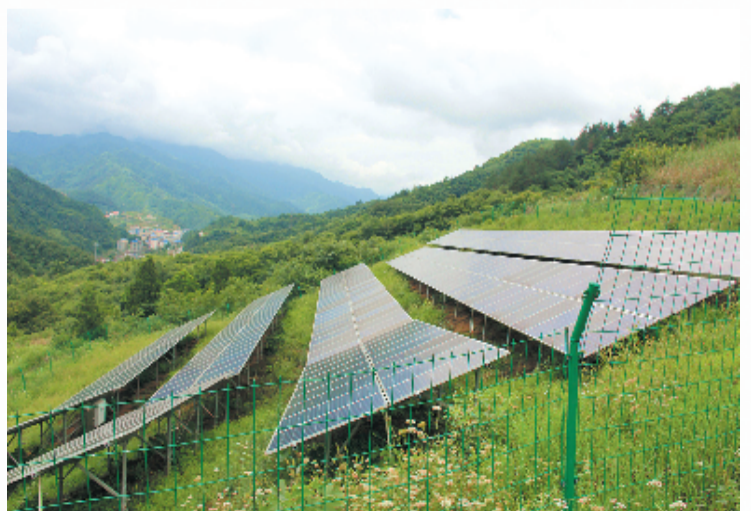
郧阳区财政局帮扶鲍峡镇东沟村建成100千瓦光伏电站
