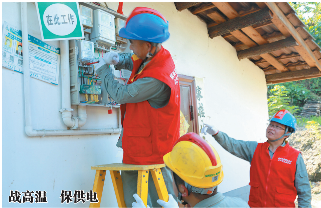
6月22日，国网竹山县供电公司庸都供电所员工冒着高温检修居民小区变电器，排查安全隐患，确保用电安全。通讯员陈昌荣 刘伟 摄
