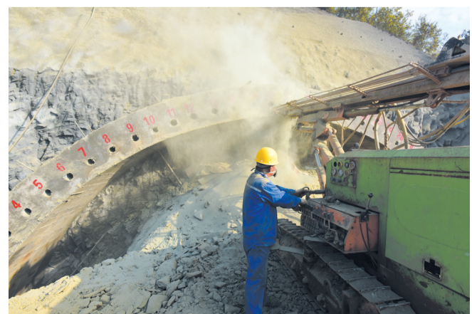
竹山城北绿色低碳经济产业园一期工程明清隧道建设现场 通讯员石濡华 摄
