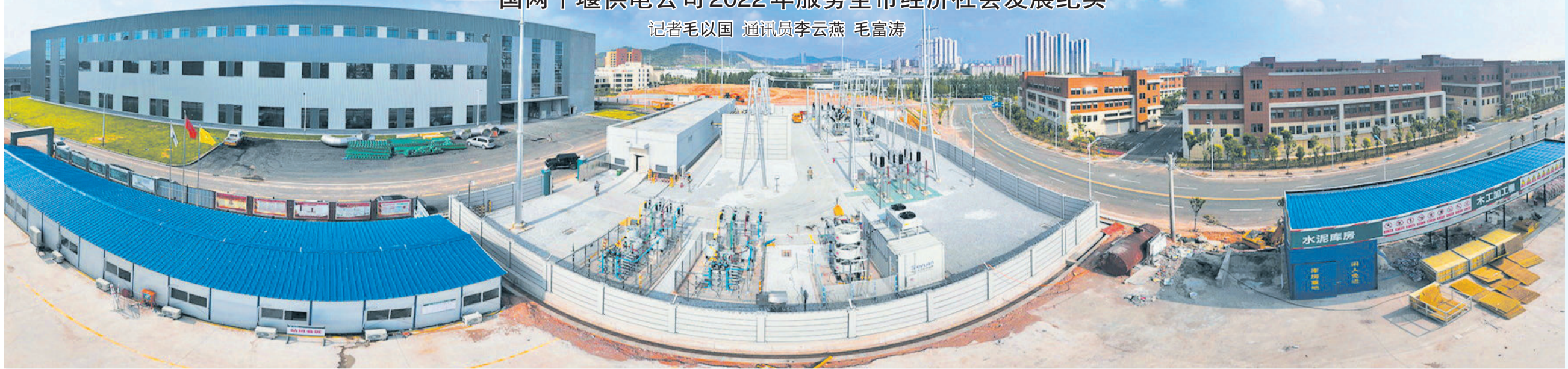
建设110千伏变电站，为重点招商引资项目十堰昊朔新能源科技有限公司提供优质服务的。
