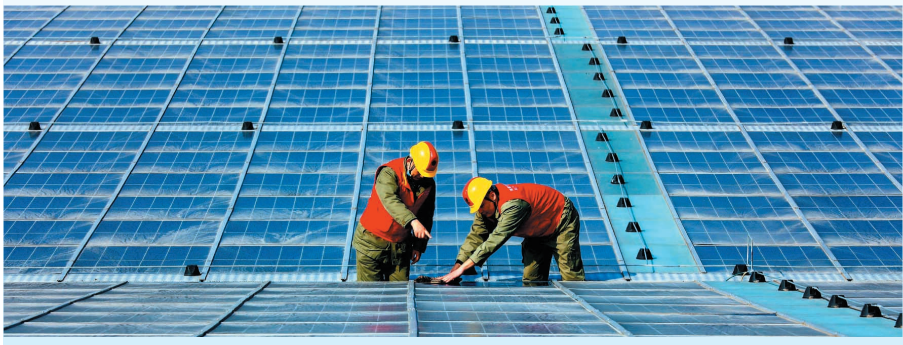
国网十堰东风供电公司党员服务队队员在东风智能装备产业园，安装22兆瓦分布式光伏项目逆变器。
