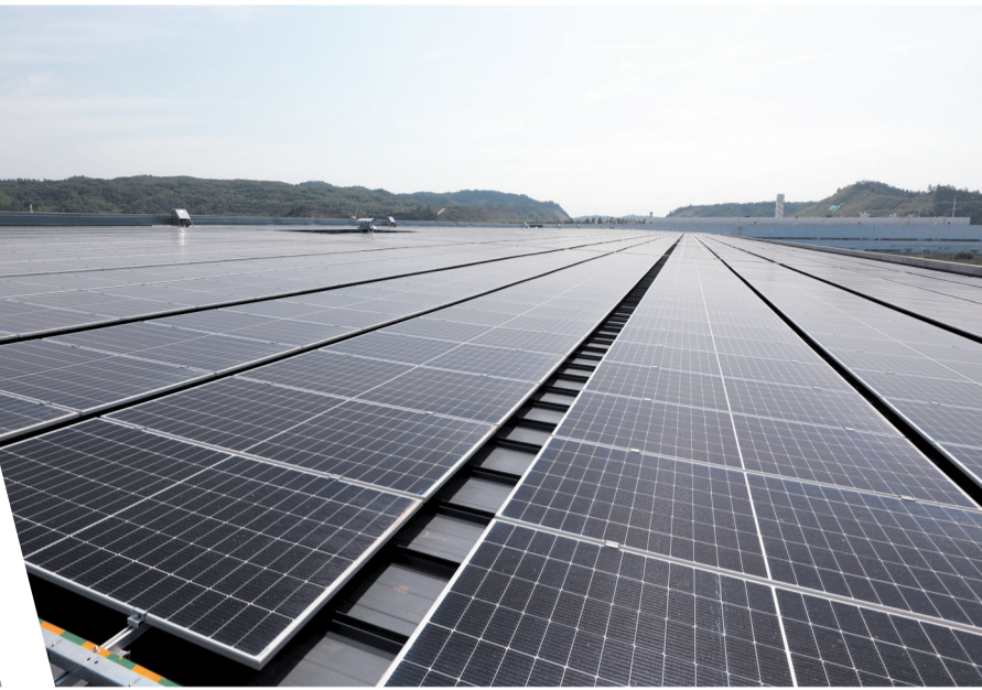
建行“光伏贷”支持东风小康空港新区光伏发电项目建设
