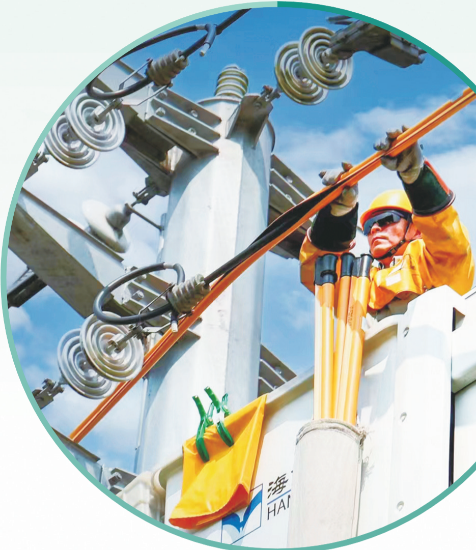
▲电力工人更换10千伏线路故障元件,保证供电不间断。 通讯员田国新 摄
