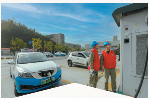
十堰电动汽车充电网络实现城区、高速、县城、乡镇全覆盖。通讯员田国新摄
