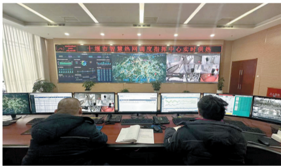
在京东东风(十堰)能源发展有限公司调度中心,工作人员详细记录温度、压力、流量等运行参数。记者曾雨摄
