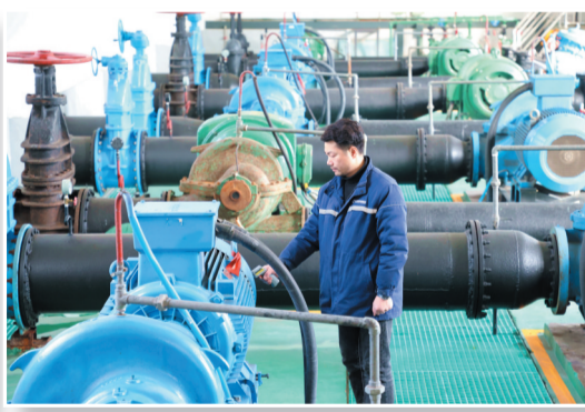
首创东风花果山自来水厂工作人员巡查水泵机组运行情况,保障居民用水无忧。记者金正摄
