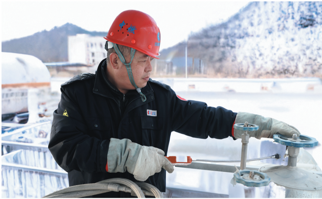
在兴业路LNG储备调峰站,工作人员对站内设备进行巡查,确保供气安全稳定。记者金正摄
