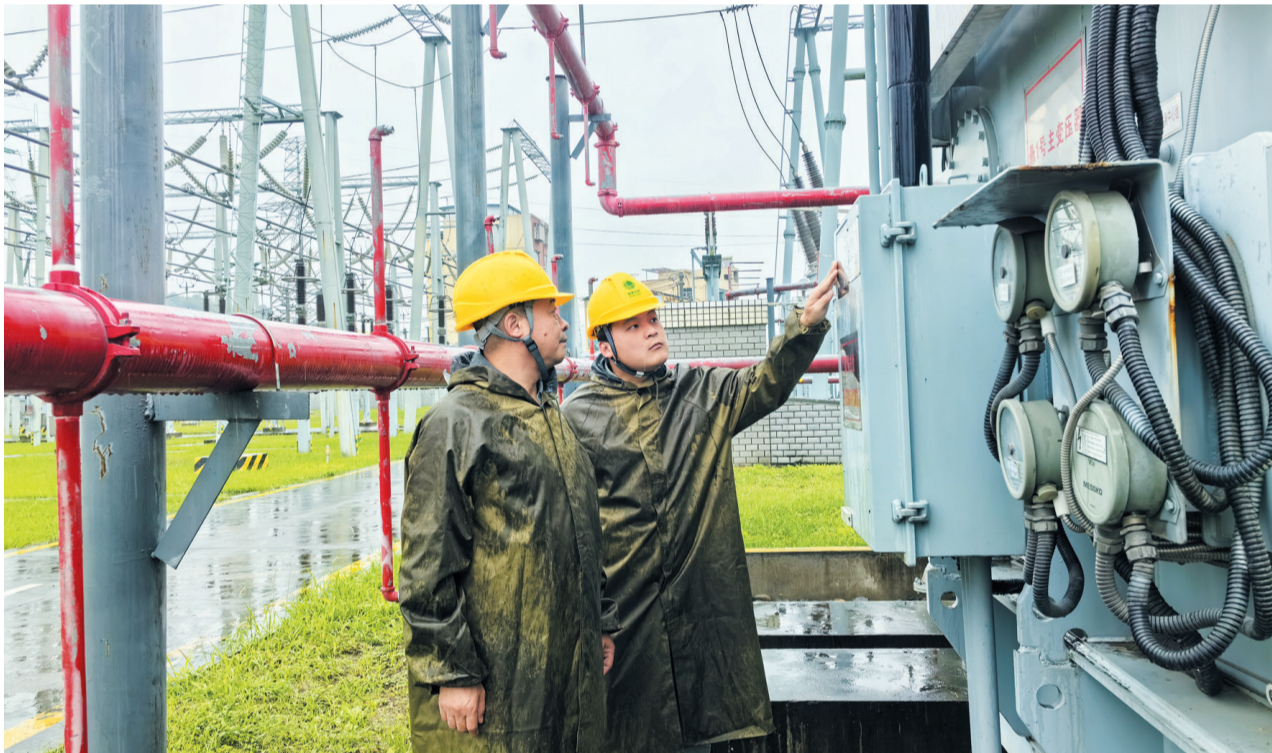
7月8日，国网十堰供电公司变电运检人员在220千伏悬鼓洲变电站开展防汛特巡。通讯员陈罡 摄
