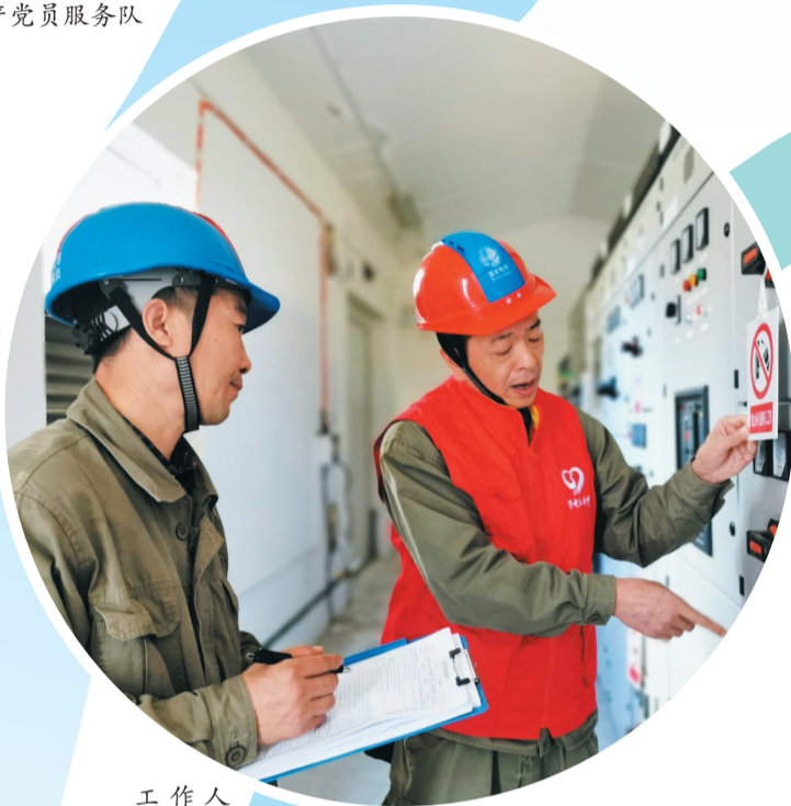
工作人员检查用户配电设施
