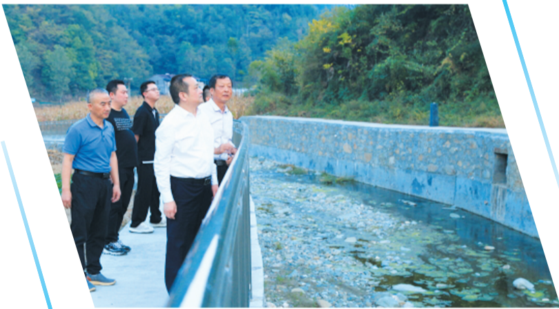
市自然资源和城乡建设局主要负责人在竹山县双台乡普渡村吉阳小学滑坡治理工程现场，检查项目建设情况。
