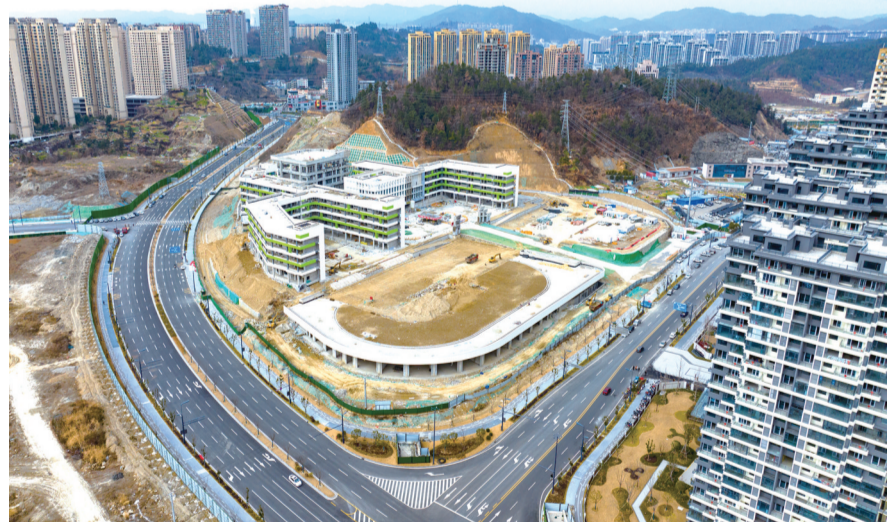
厦门路学校建设进入收尾阶段,计划于3月底前完成教学楼交付。
