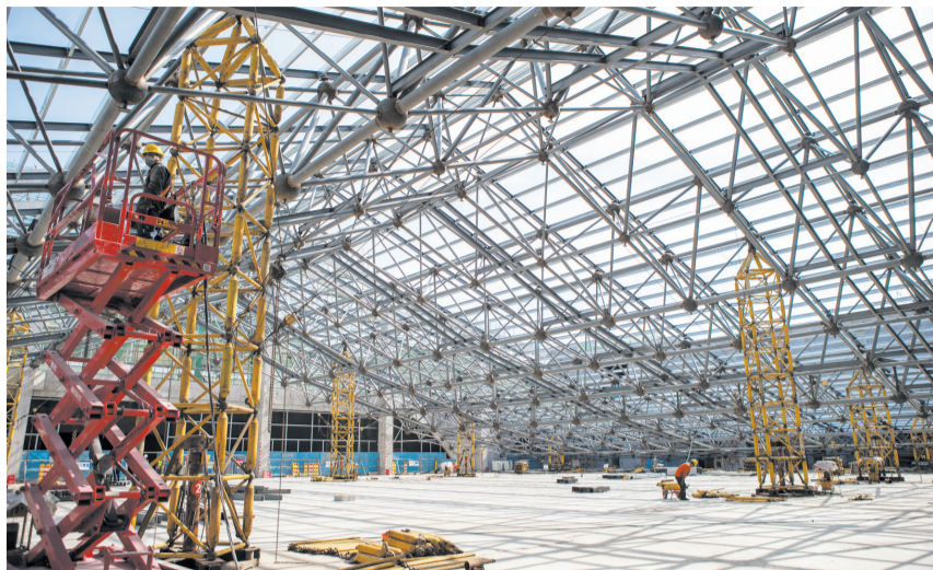
工人们在进行候车大厅钢网架整体提升作业。记者刘昆摄
