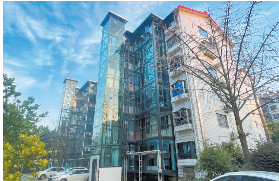
茅箭区五堰街道六堰山社区郟中家园小区加装的平层入户电梯。
