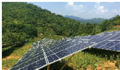
建行十堰分行援建的光伏扶贫电站
