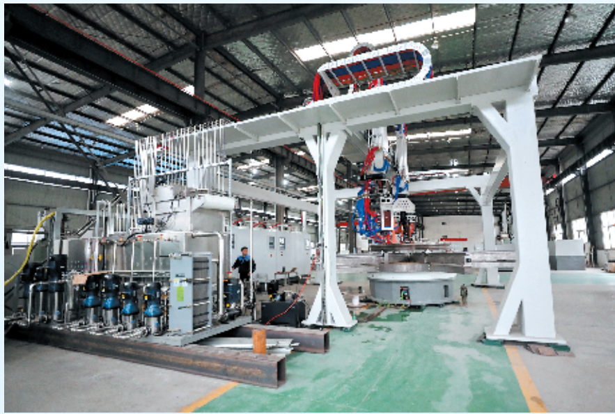
十堰高周科工贸有限公司成功研发中国首台风电海缆高精度水感应装备
