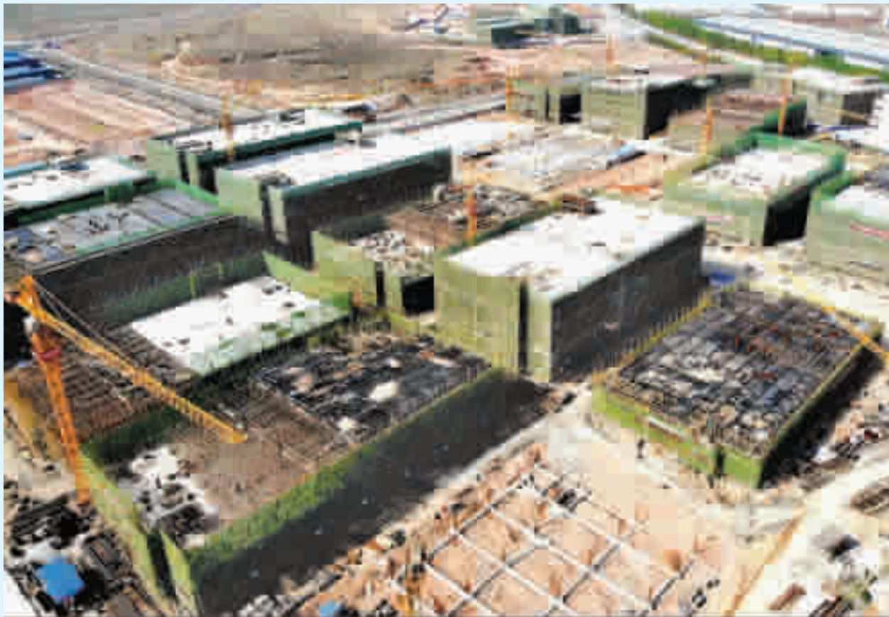
秦巴片区产业扶贫示范园项目
