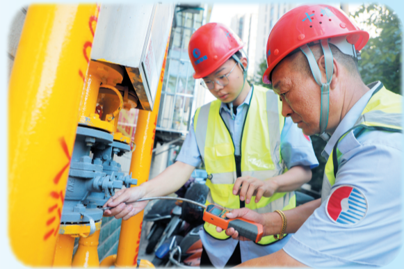
7月18日,十堰中燃公司巡检员在茅箭区二堰街道吉祥小区检测燃气供应设备。
