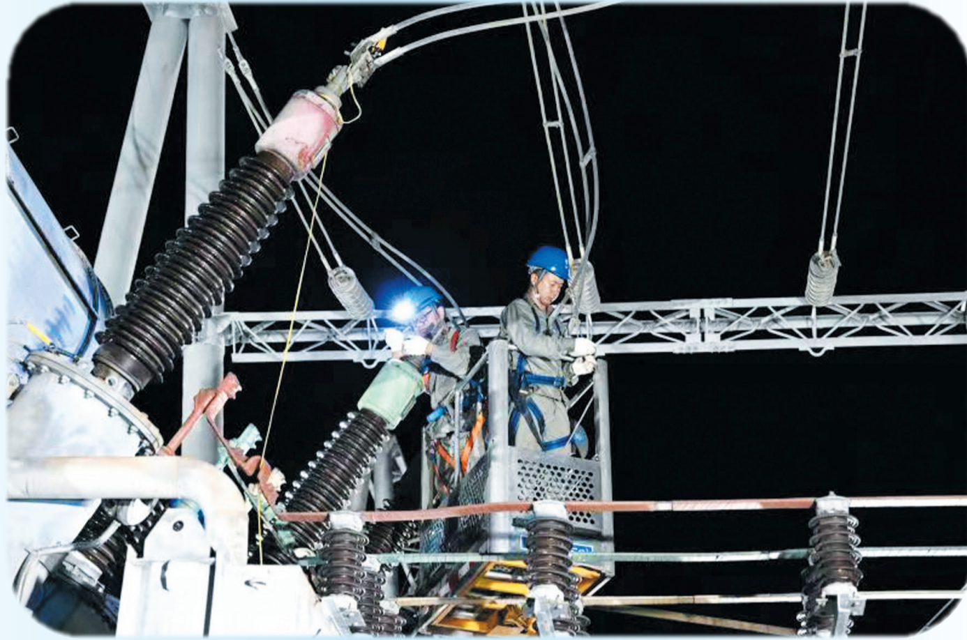
7月17日凌晨,在220千伏武当山变电站内,国网十堰供电公司变电运维检修人员对110千伏倒套管发热问题进行处理,确保设备恢复到安全可靠运行状态。
