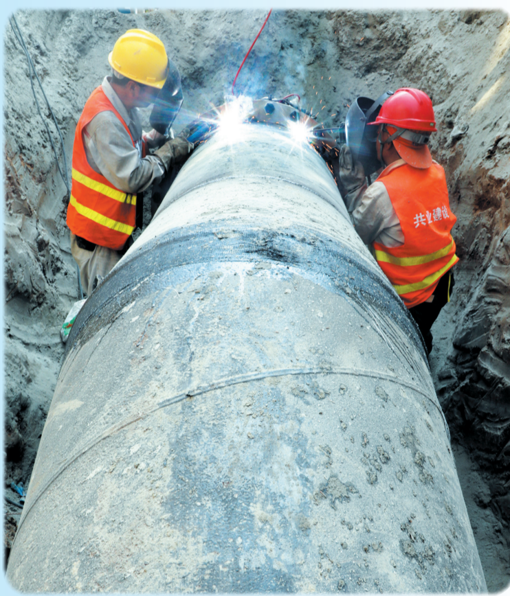
7月18日,工人们在车城西路铺设供水主管道,确保居民夏季用水无忧。
