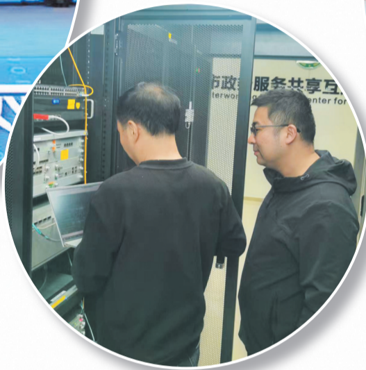
检查市政务外网交换机房网络情况。
